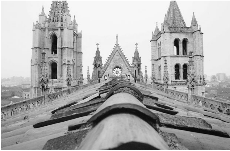
La cubierta de la Catedral se encuentra en un estado desolador
